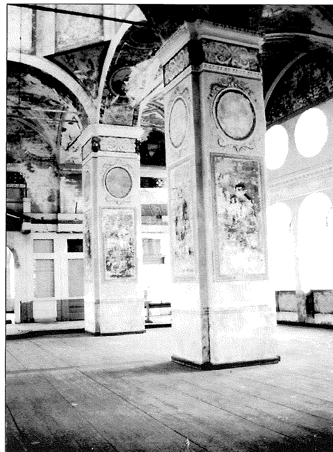
Pääkirkon toisessa kerroksessa sijaitsevan yläkirkon koristemaalaukset ovat osittain varsin hyvin säilyneitä, mutta kyllä korjattavaakin riittä kuten pylväihin maalatuista ikoneista näkyy.
